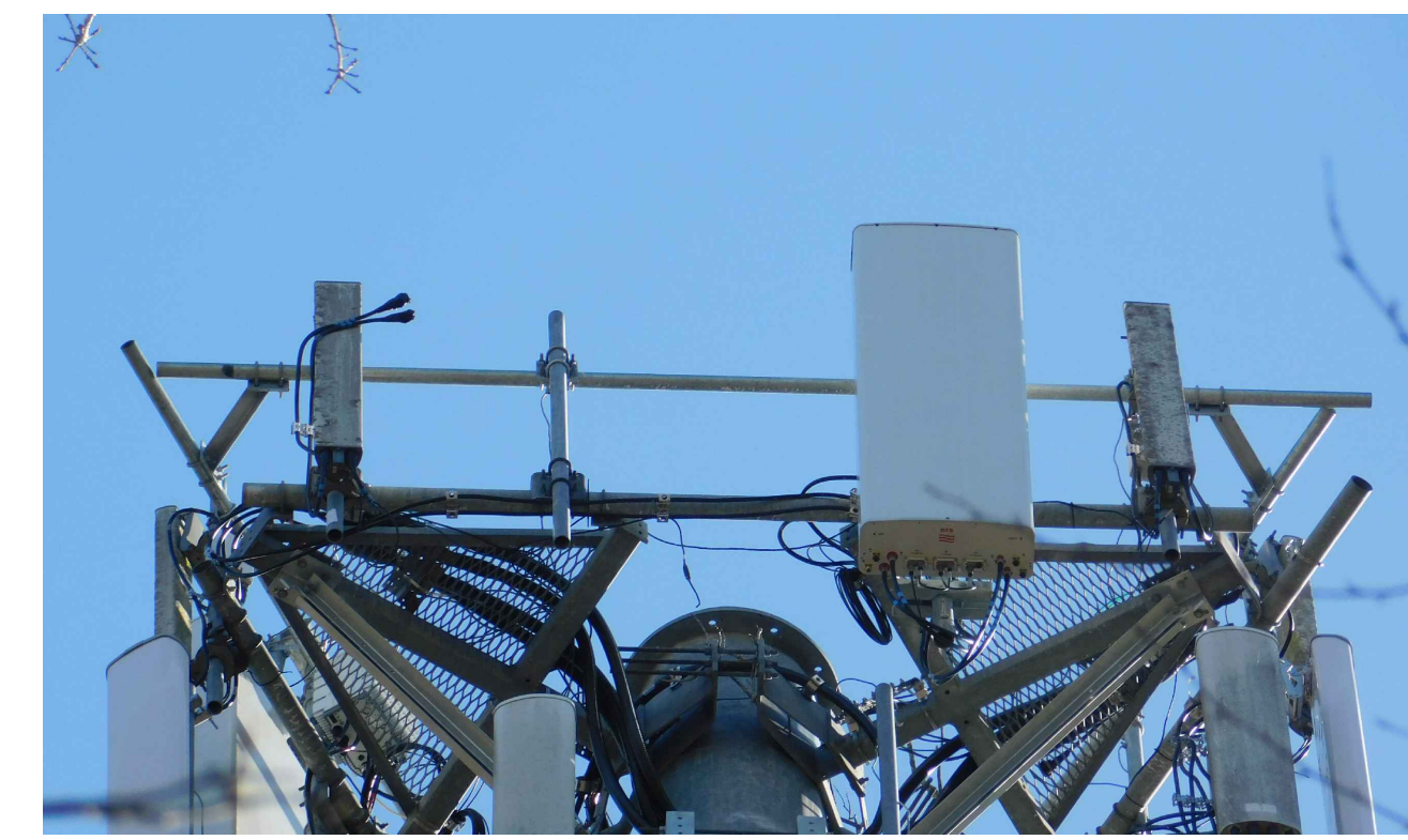
EXISTING ANTENNA PHOTO SCALE: N.T.S.
