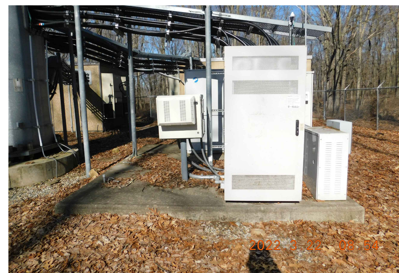
EXISTING EQUIPMENT PHOTO SCALE: N.T.S.
