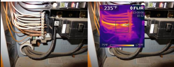
110.14 (A) 2 wires under 1 lug
