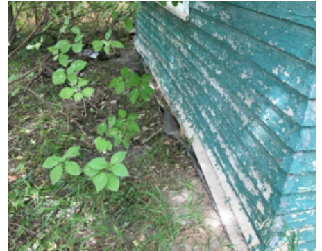
Limpieza de Brownfields, Reservación Spirit Lake. Foto de un edificio abandonado contaminado con asbesto, pintura con plomo y plomo en la tierra.
