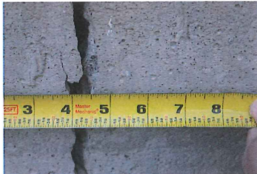
(d) wide crack opening
