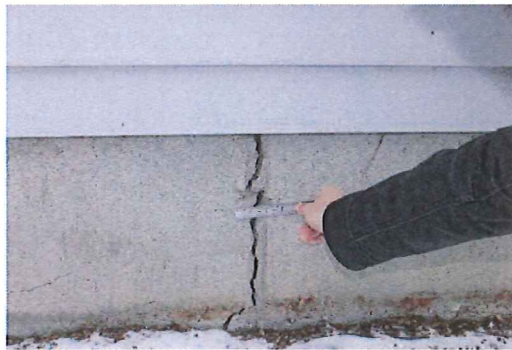
(d) wide crack opening
