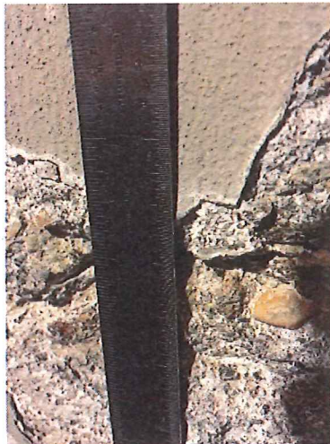
(d) wide crack opening
