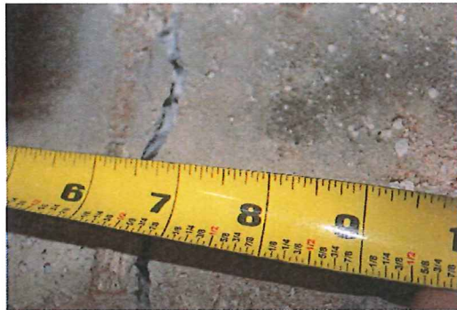
(d) wide crack opening
