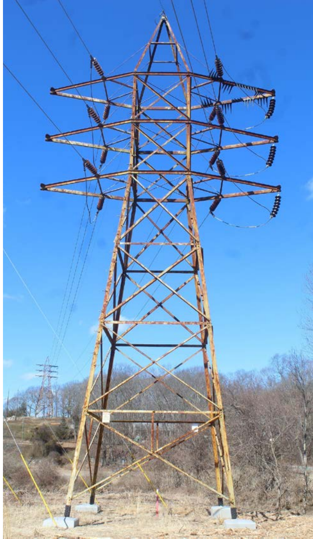
Str# 7011 - Steel Corrosion
