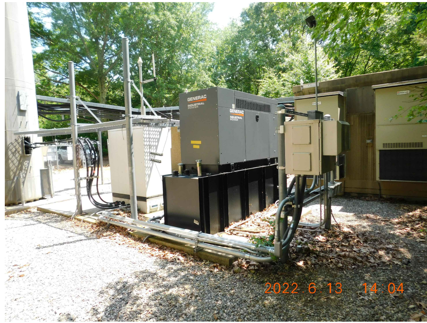
EXISTING EQUIPMENT PHOTO 2 SCALE: N.T.S.
