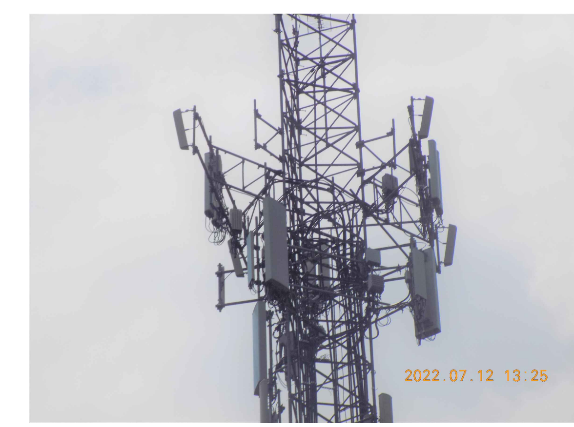
EXISTING ANTENNA PHOTO SCALE: N.T.S.
