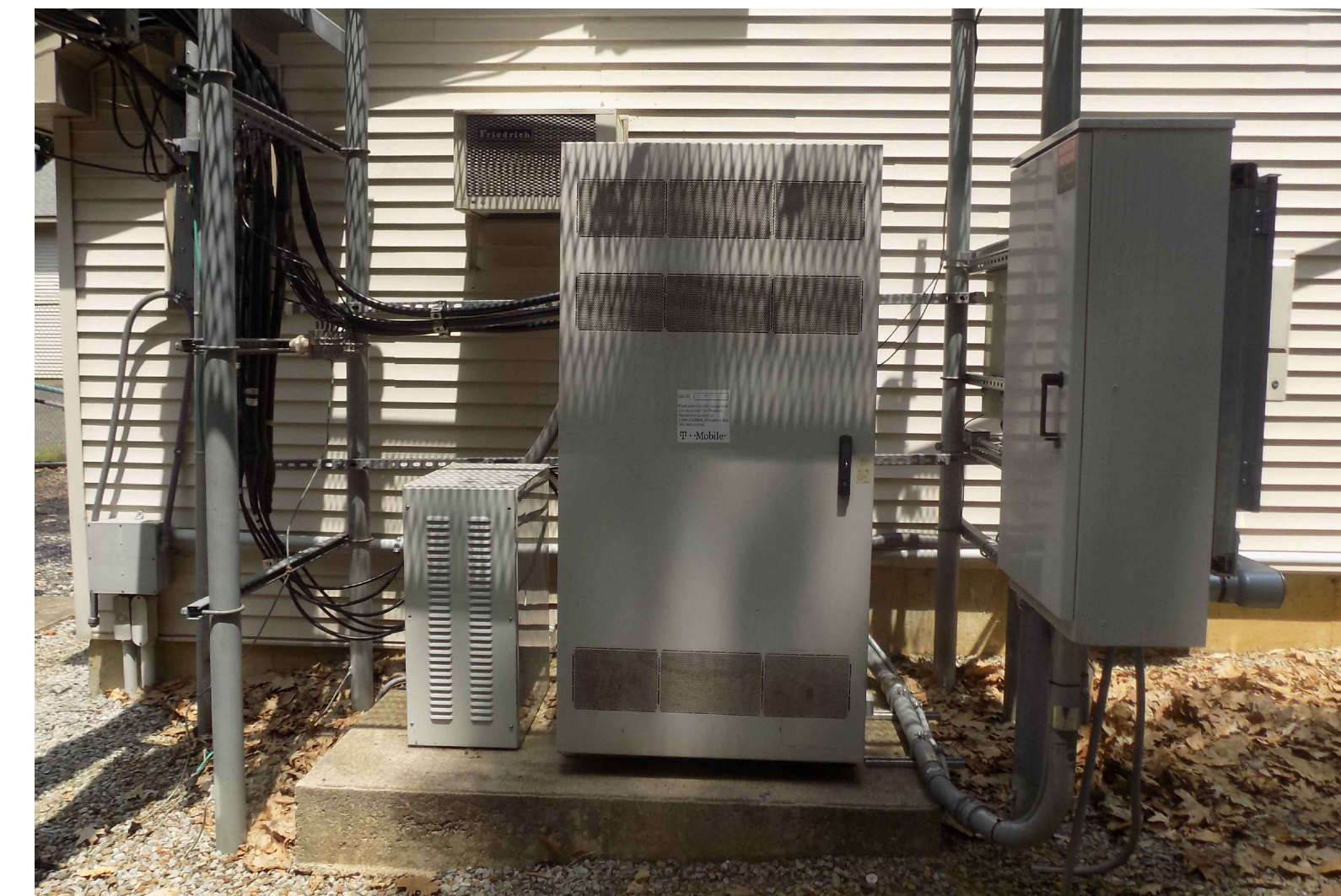
EXISTING EQUIPMENT PHOTO 2 SCALE: N.T.S. A-1
