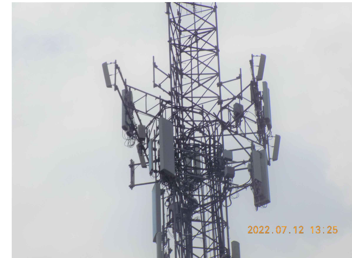
EXISTING ANTENNA PHOTO SCALE: N.T.S.
