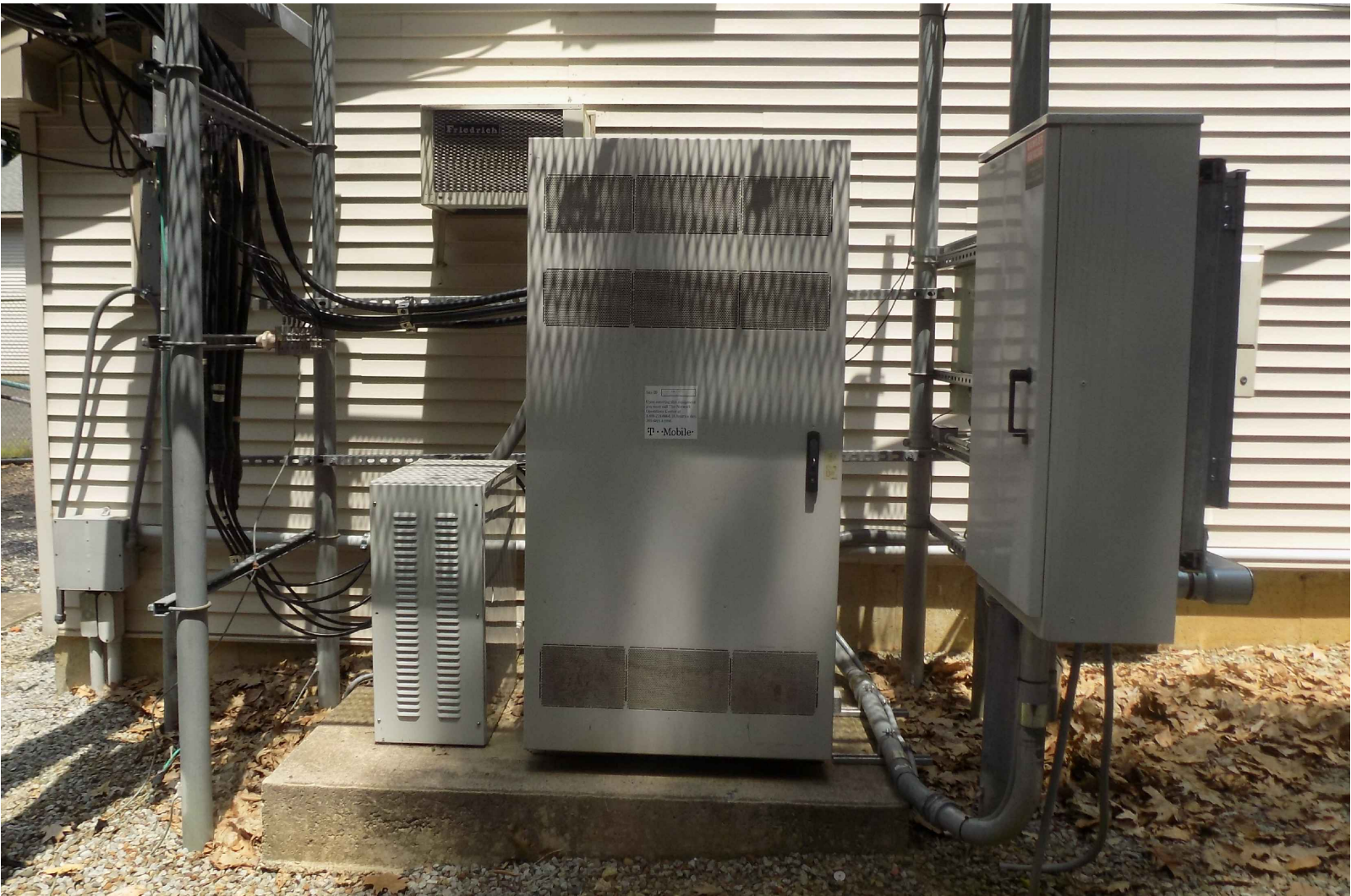
EXISTING EQUIPMENT PHOTO 2 SCALE: N.T.S. A-1
