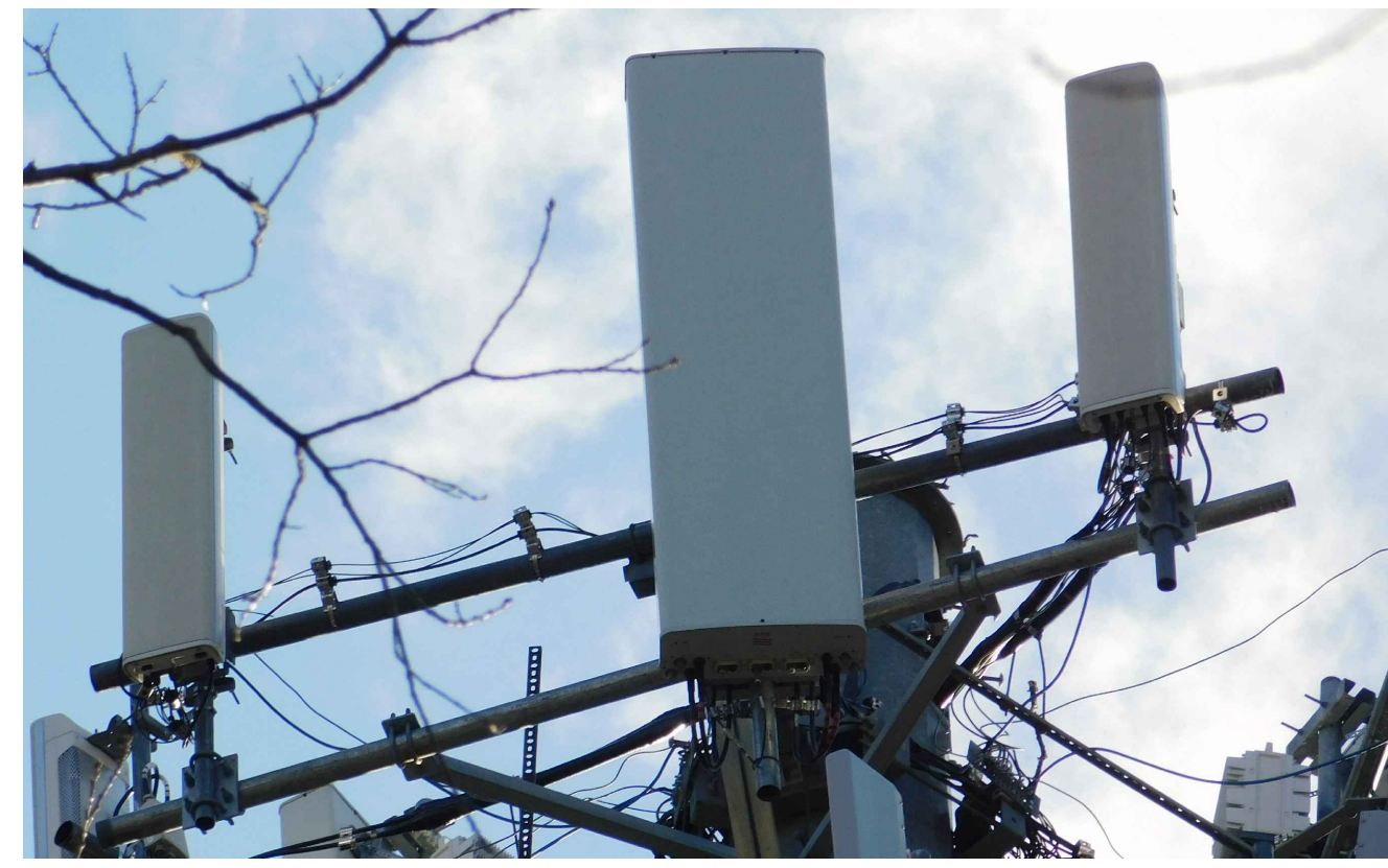
EXISTING ANTENNA PHOTO SCALE: N.T.S.
