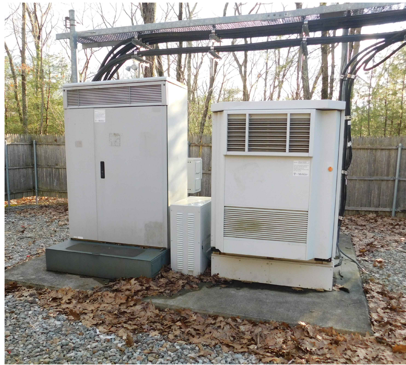
EXISTING EQUIPMENT PHOTO SCALE: N.T.S.
