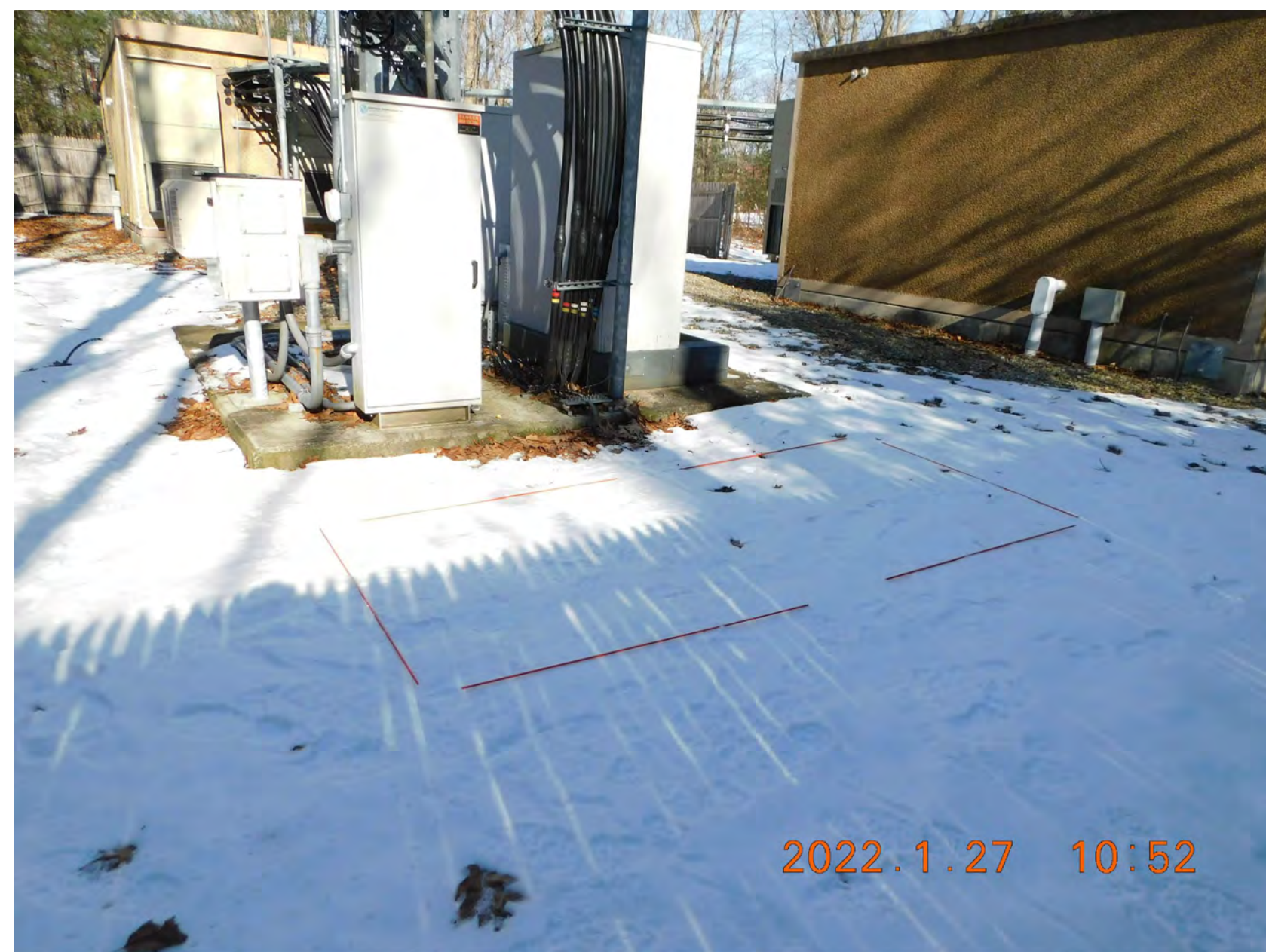
EXISTING EQUIPMENT PHOTO SCALE: N.T.S. 2 A-1
