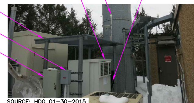
EXISTING EQUIPMENT PHOTO DETAIL SCALE: N.T.S. 3 A-1
