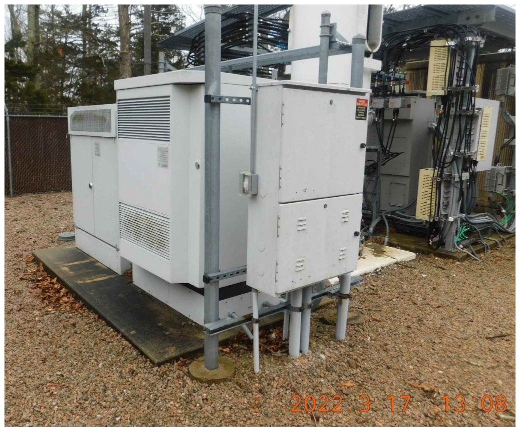
EXISTING EQUIPMENT PHOTO 2 SCALE: N.T.S.
