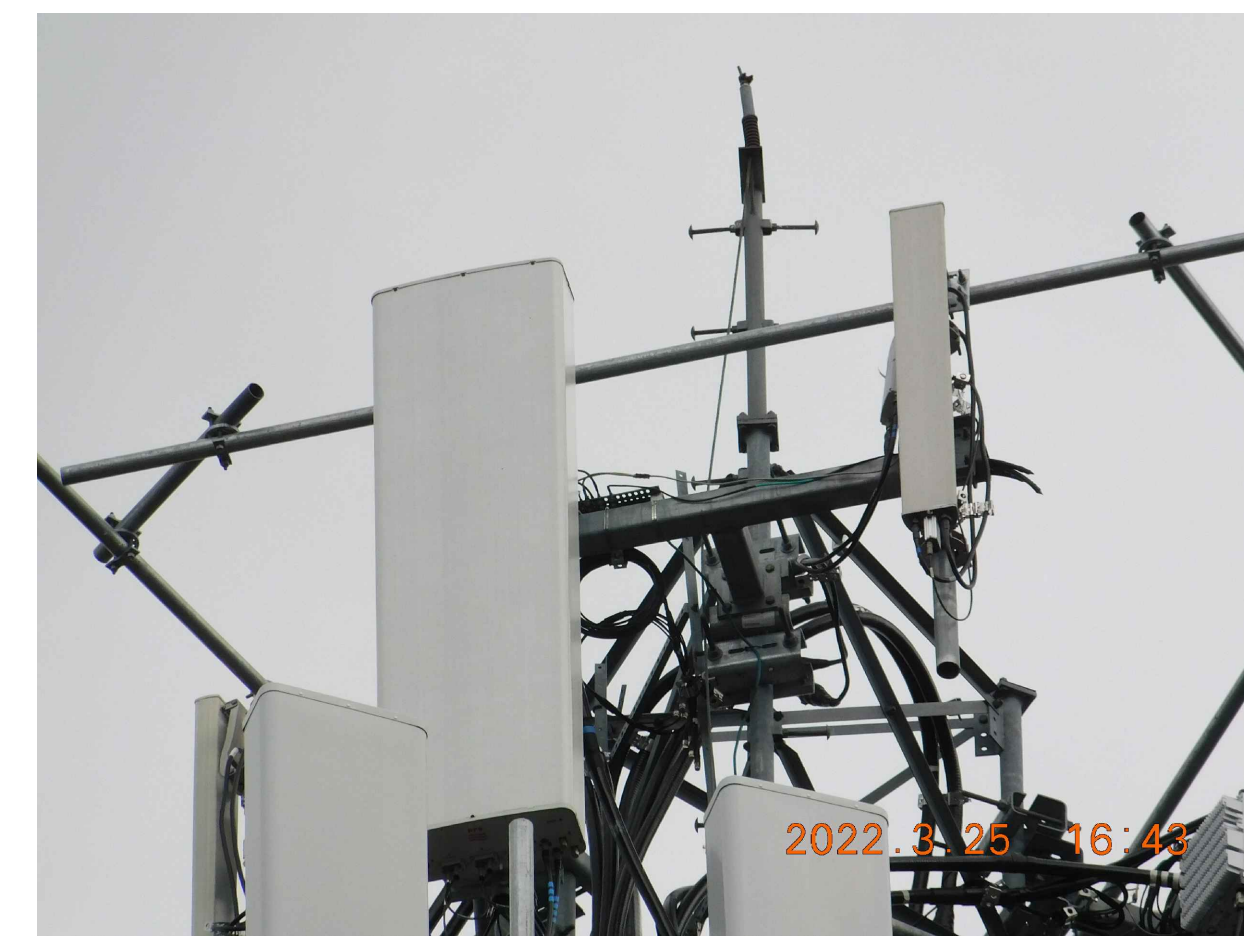
EXISTING ANTENNA PHOTO SCALE: N.T.S.
