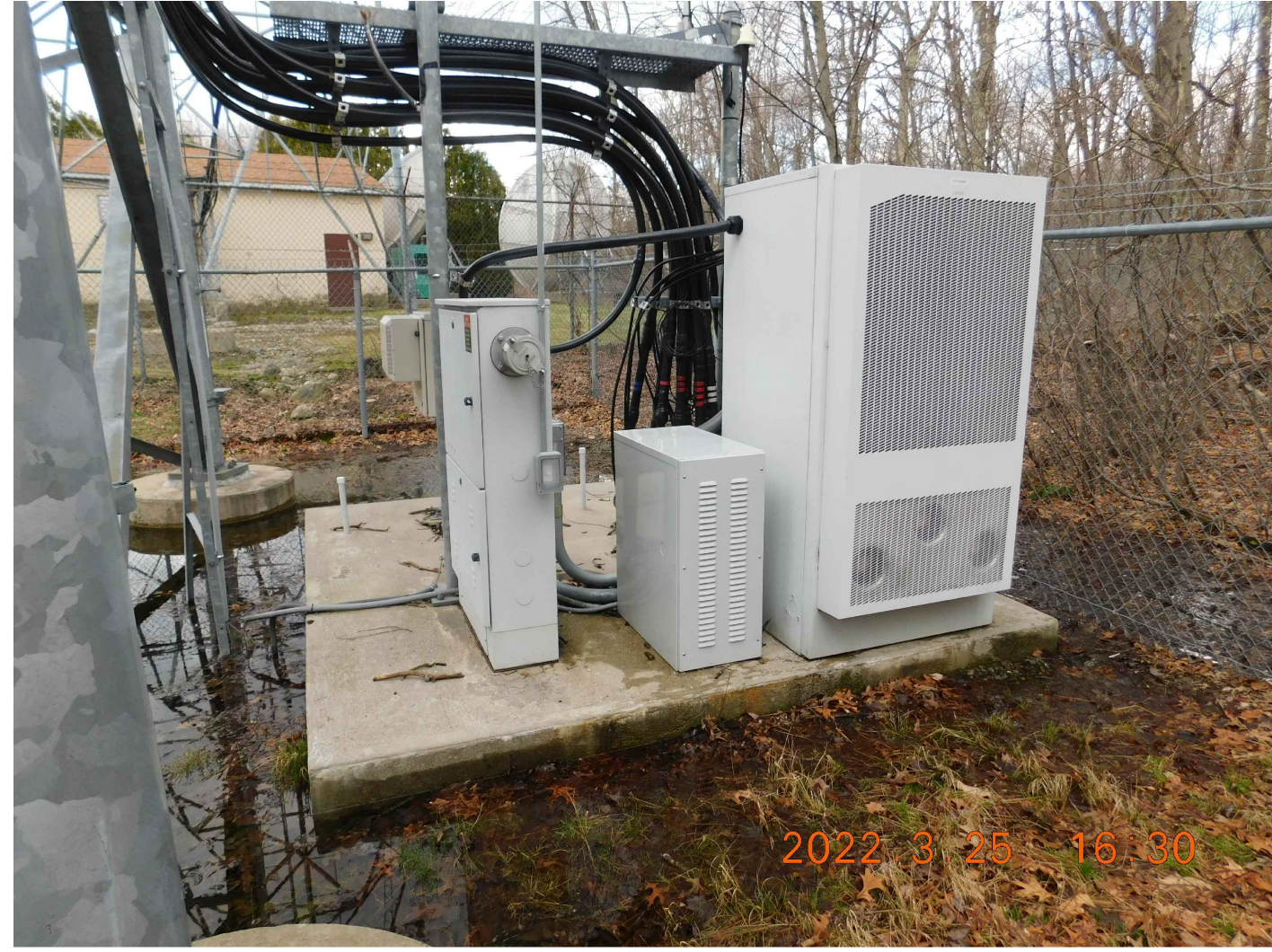
EXISTING EQUIPMENT PHOTO 2 SCALE: N.T.S. A-1
