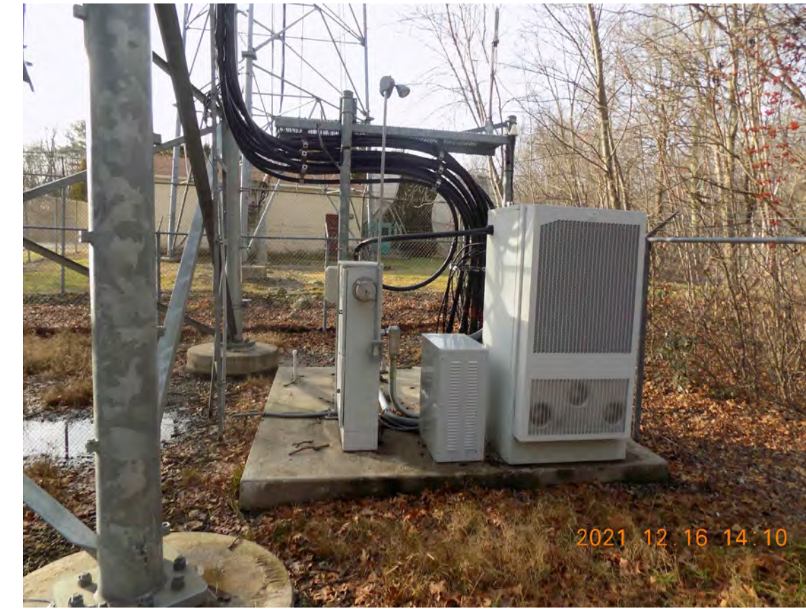
EXISTING EQUIPMENT PHOTO 2 SCALE: N.T.S. A-1
