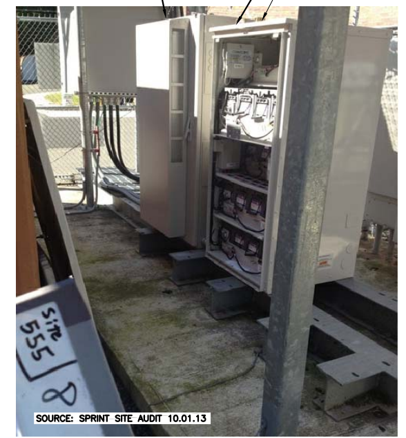
RAN EQUIPMENT PHOTO DETAIL 2 SCALE: N.T.S. A-1
