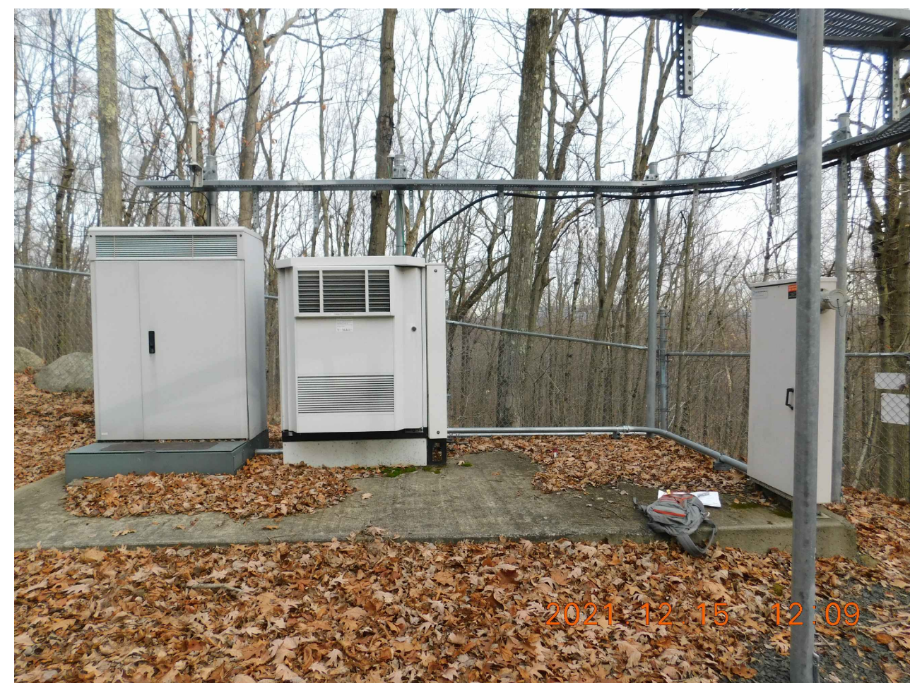
EXISTING EQUIPMENT PHOTO SCALE: N.T.S. 2 A-1
