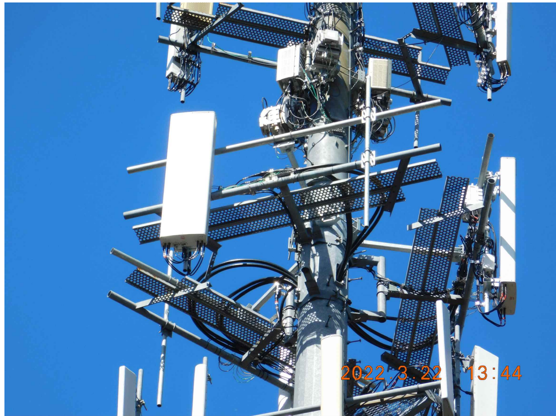
EXISTING ANTENNA PHOTO SCALE: N.T.S.
