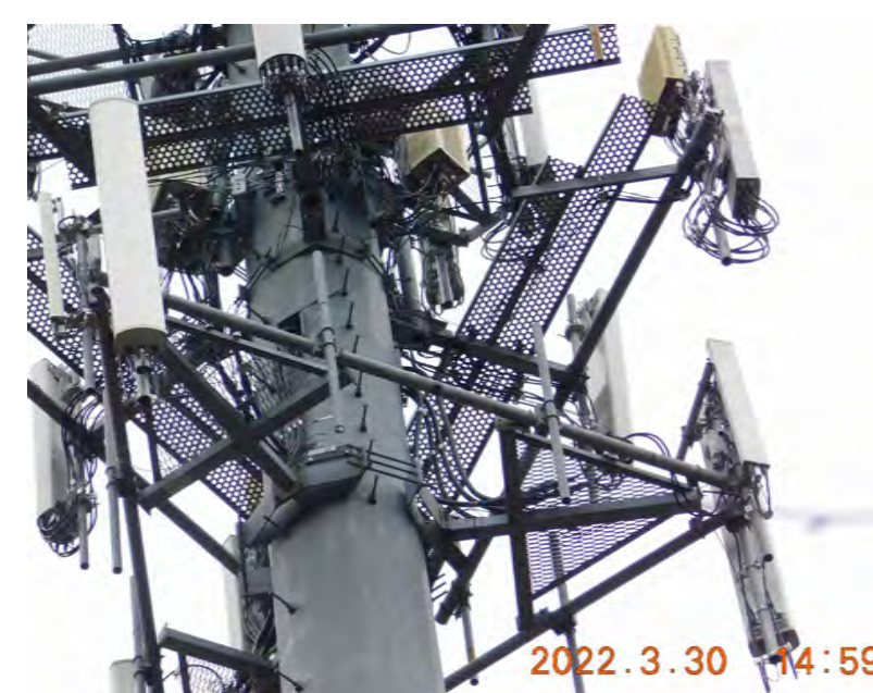
EXISTING ANTENNA PHOTO SCALE: N.T.S.
