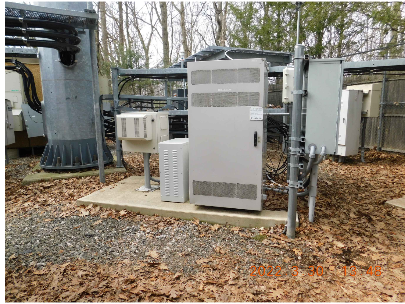
EXISTING EQUIPMENT PHOTO 2 SCALE: N.T.S.
