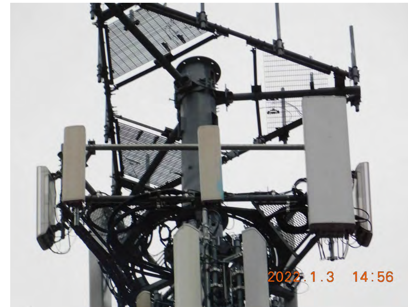
EXISTING ANTENNA PHOTO SCALE: N.T.S.
