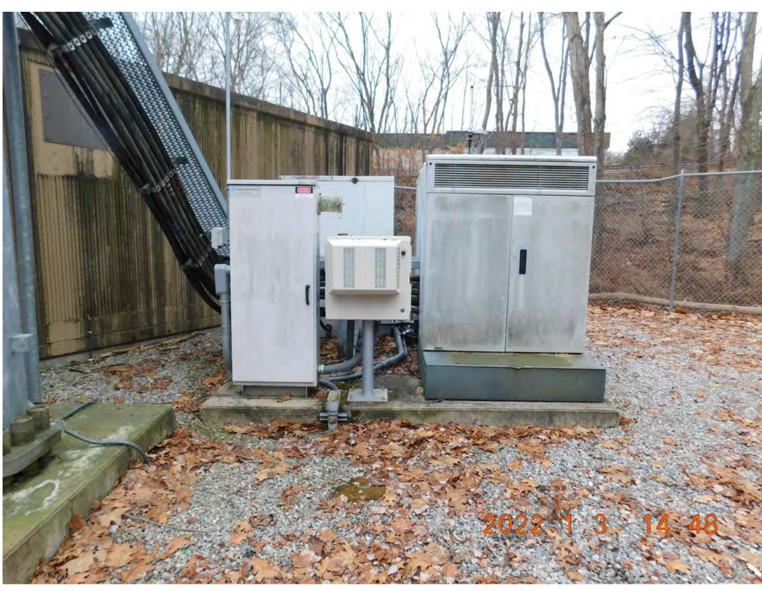
EXISTING EQUIPMENT PHOTO 2 SCALE: N.T.S. A-1
