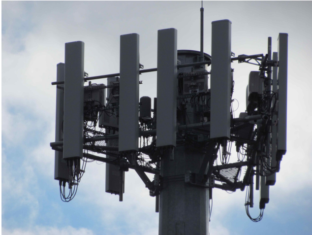
Existing AT&T Antennas
