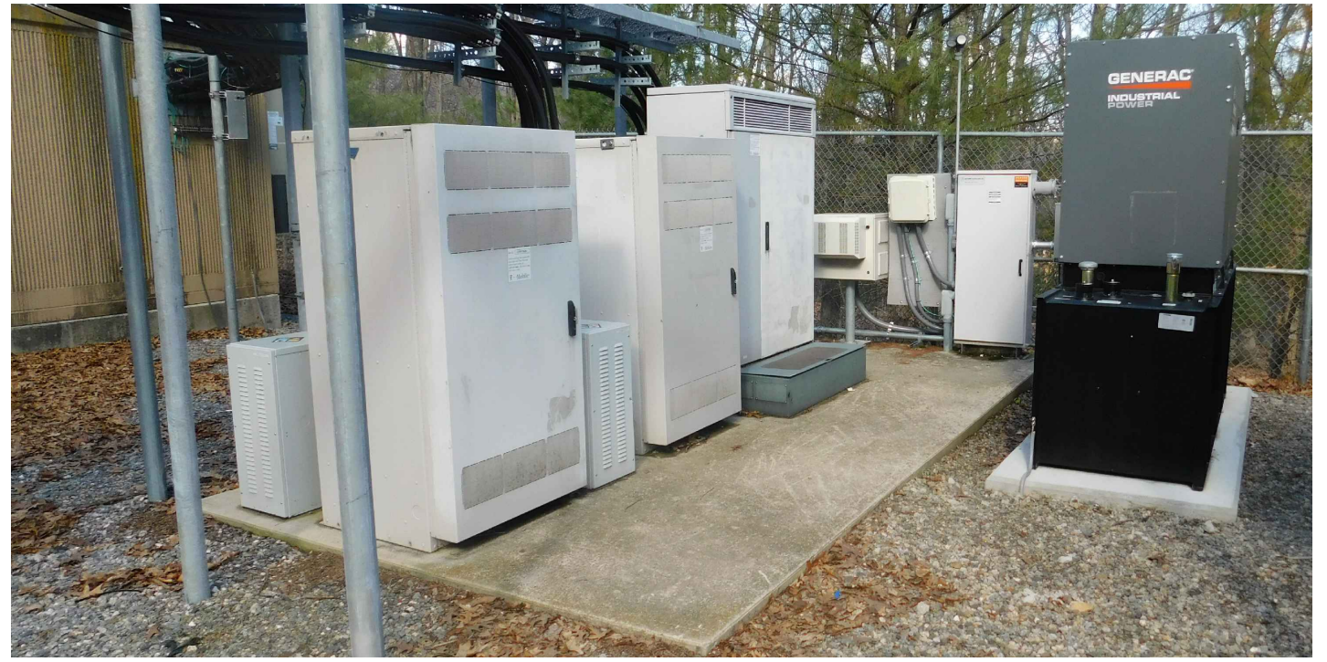
EXISTING EQUIPMENT PHOTO 2 SCALE: N.T.S.
