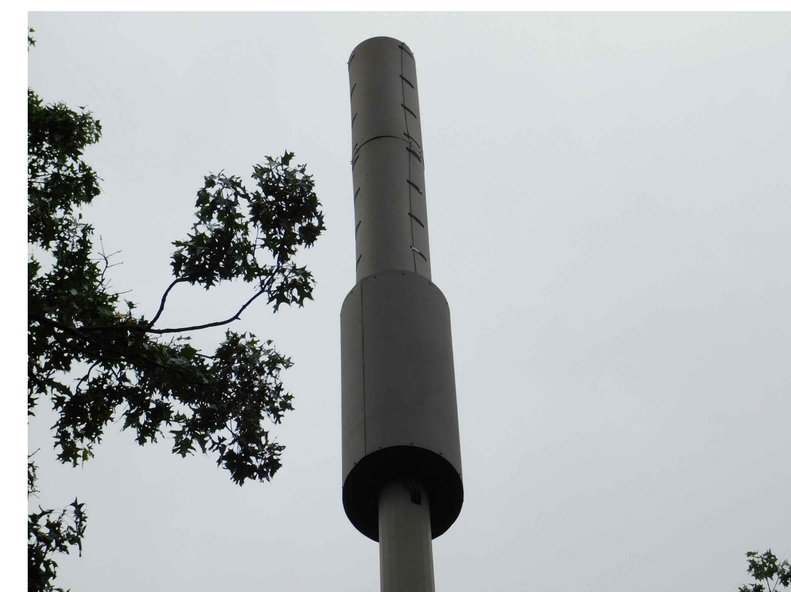
EXISTING ANTENNA PHOTO SCALE: N.T.S.
