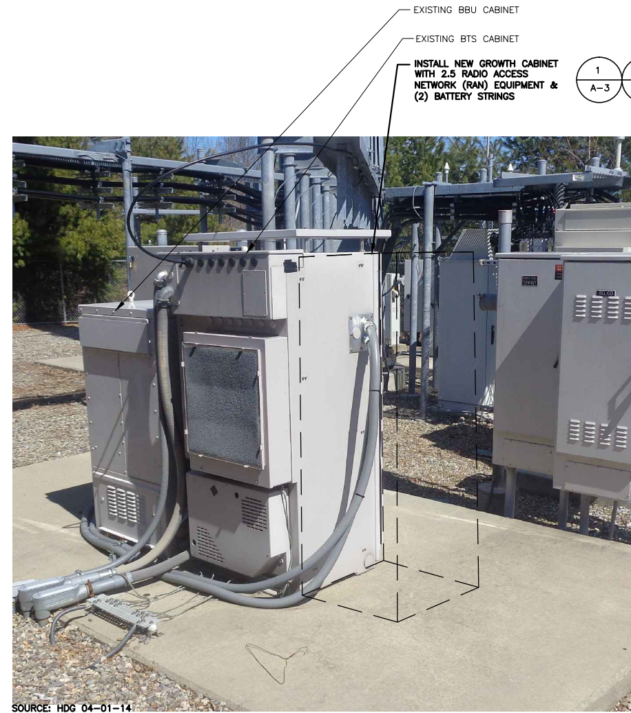
RAN EQUIPMENT PHOTO DETAIL 2 SCALE: N.T.S. A-1
