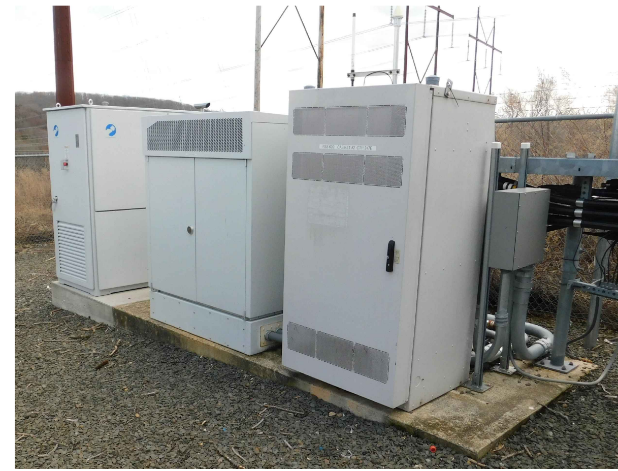
EXISTING EQUIPMENT PHOTO 2 SCALE: N.T.S.
