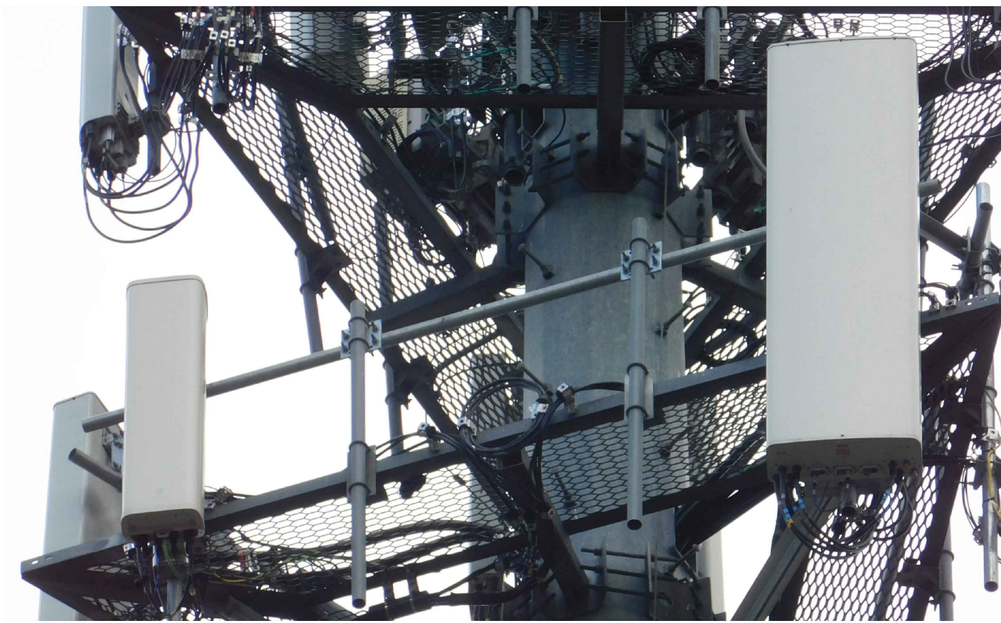
EXISTING ANTENNA PHOTO SCALE: N.T.S.
