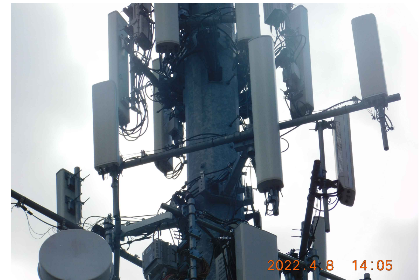
EXISTING ANTENNA PHOTO 3 N.T.S. A-2
