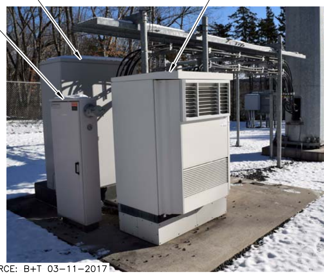
2B EQUIPMENT PHOTO DETAIL SCALE: N.T.S.
