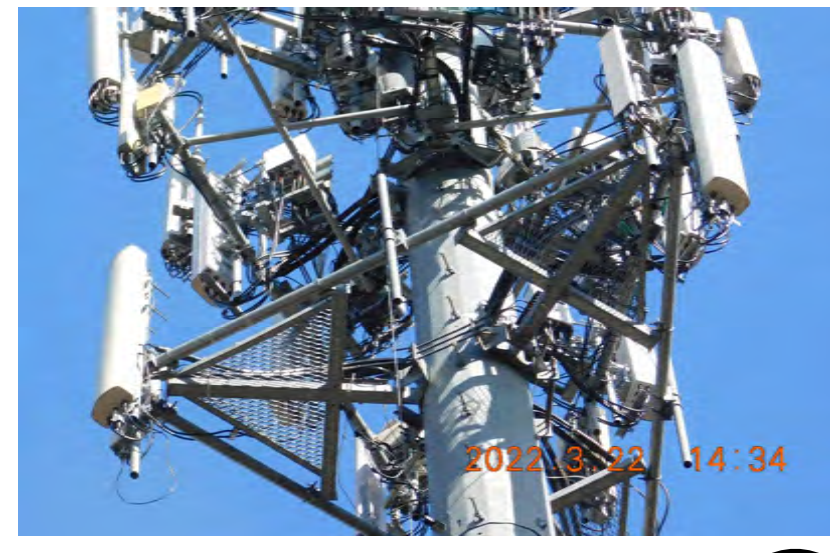
EXISTING ANTENNA PHOTO SCALE: N.T.S.
