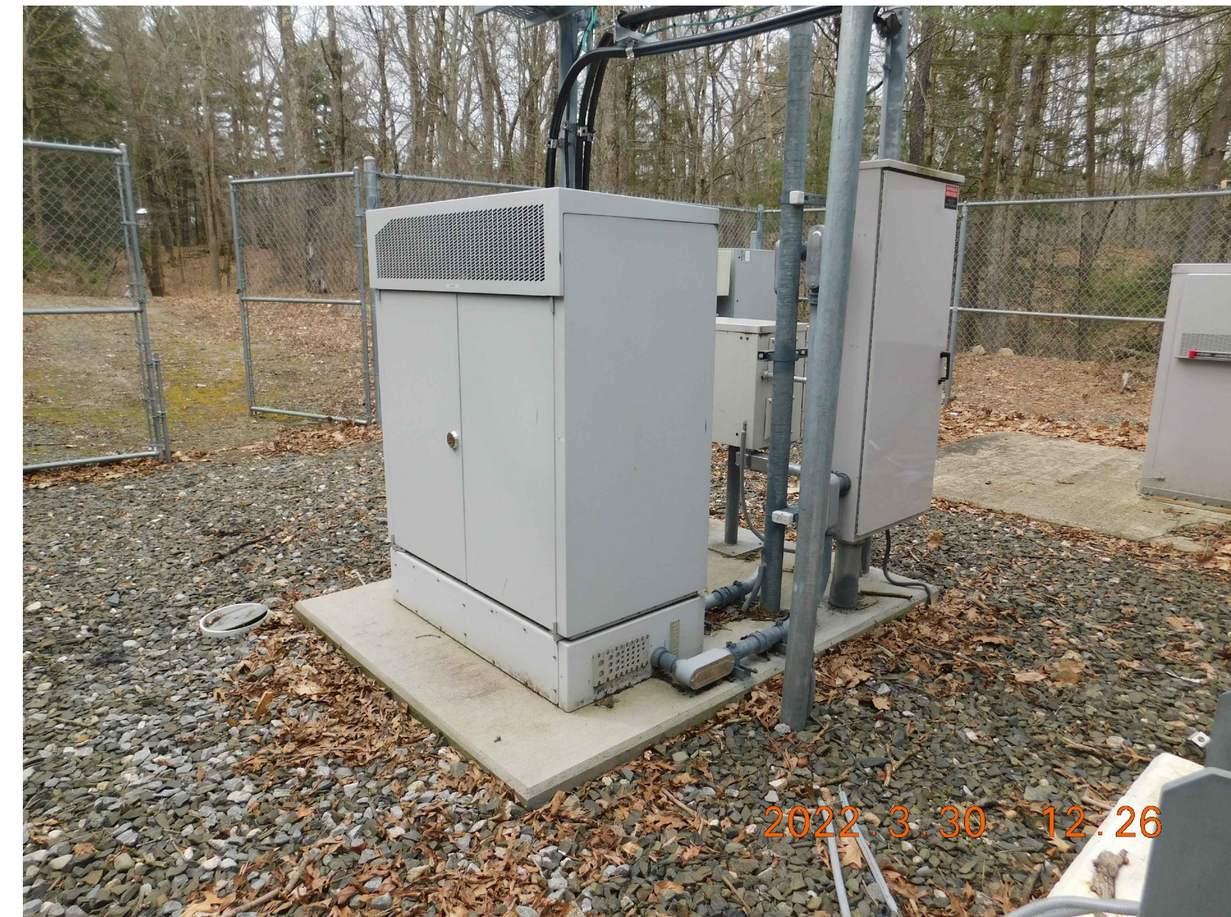
EXISTING EQUIPMENT PHOTO 2 SCALE: N.T.S.
