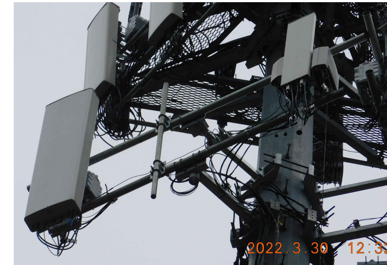
EXISTING ANTENNA PHOTO SCALE: N.T.S.
