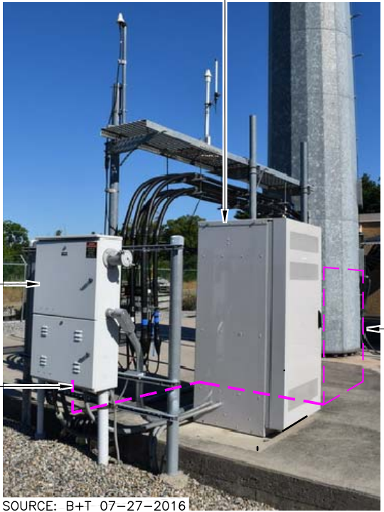
2B EQUIPMENT PHOTO DETAIL SCALE: N.T.S.
