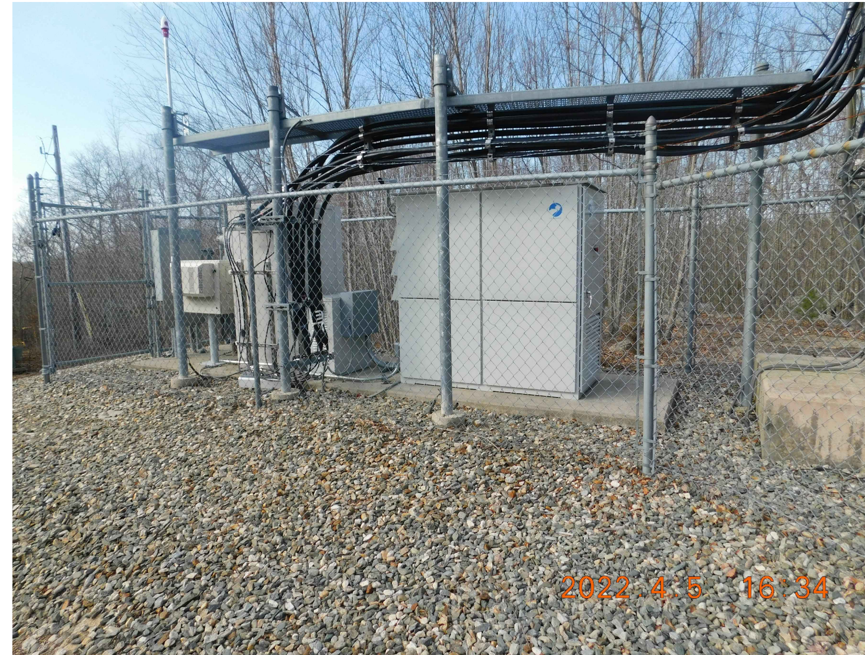
EXISTING EQUIPMENT PHOTO 2 SCALE: N.T.S.
