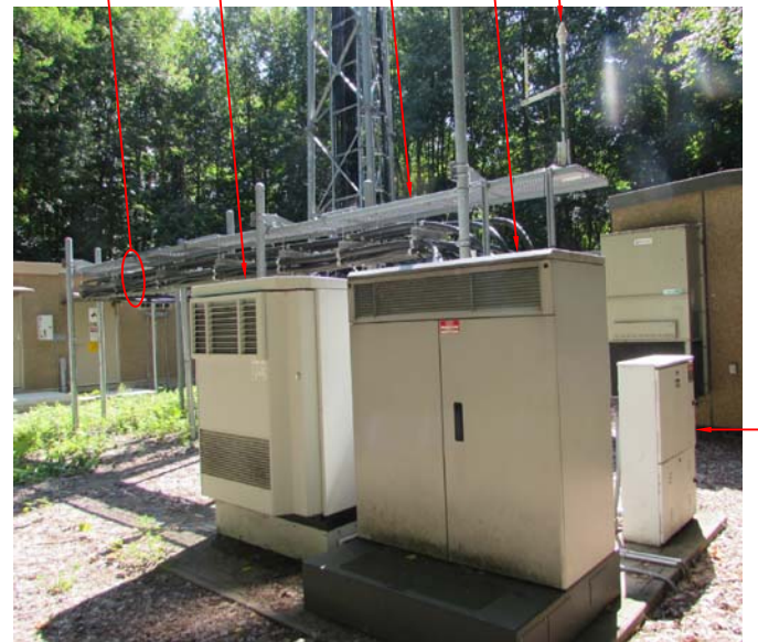
EQUIPMENT PHOTO DETAIL SCALE: N.T.S.
