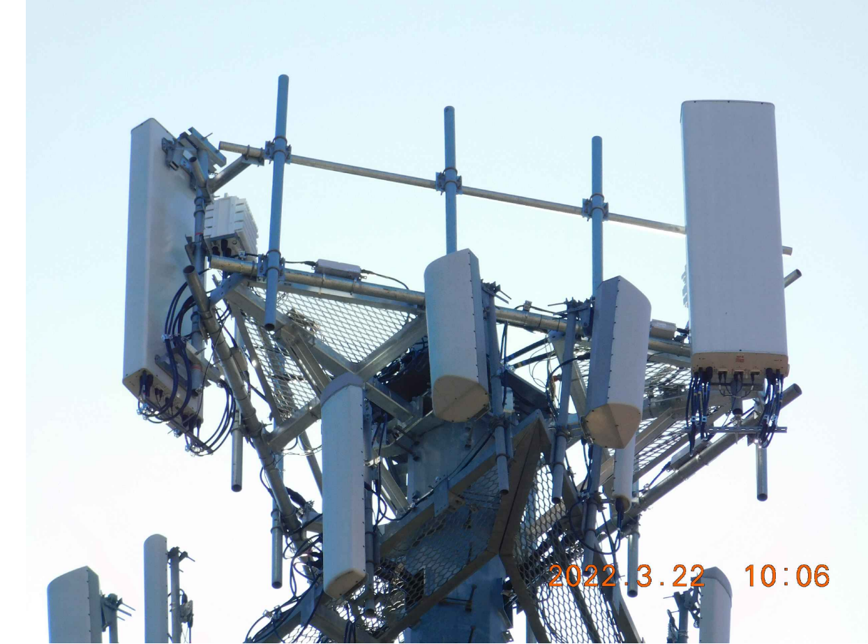
EXISTING ANTENNA PHOTO SCALE: N.T.S.
