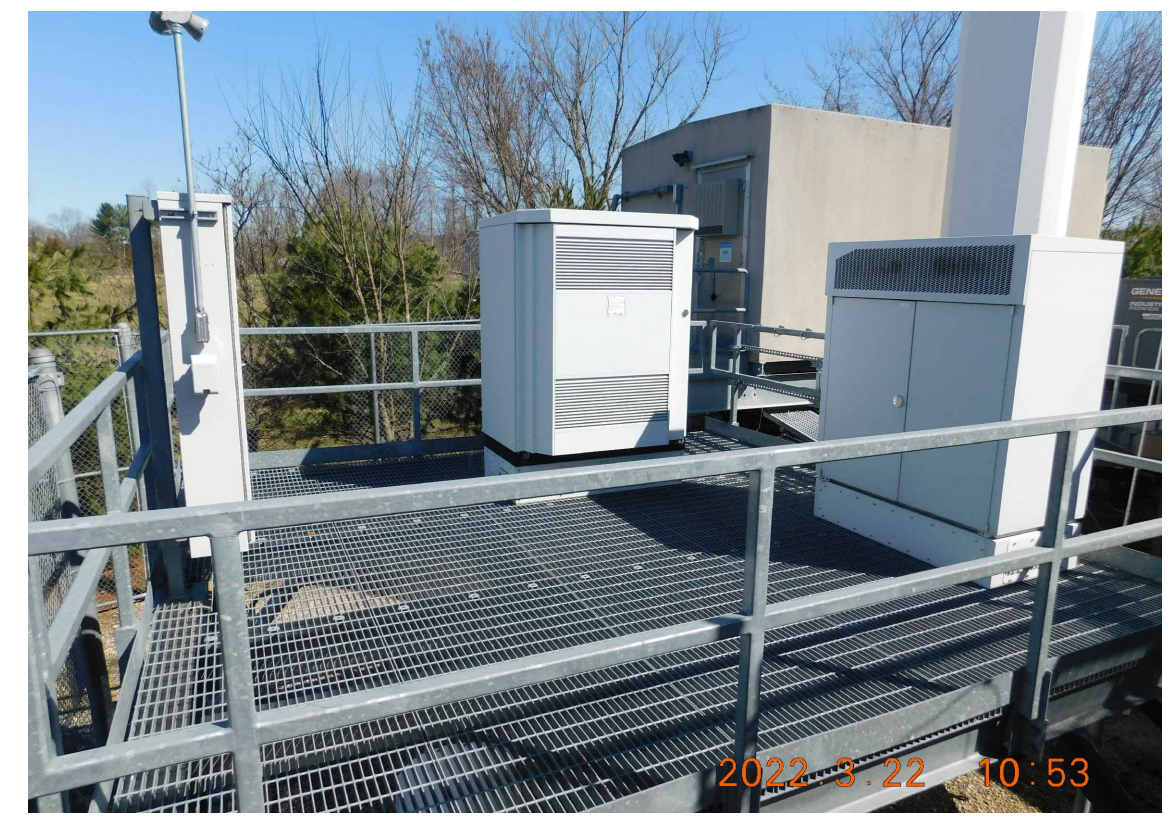
EXISTING EQUIPMENT PHOTO SCALE: N.T.S.
