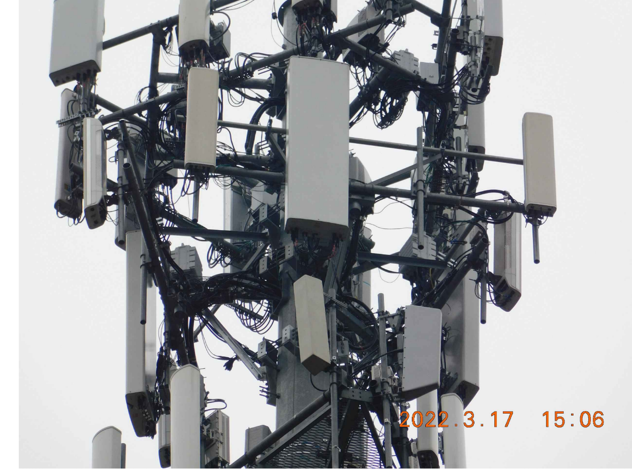
EXISTING ANTENNA PHOTO SCALE: N.T.S.
