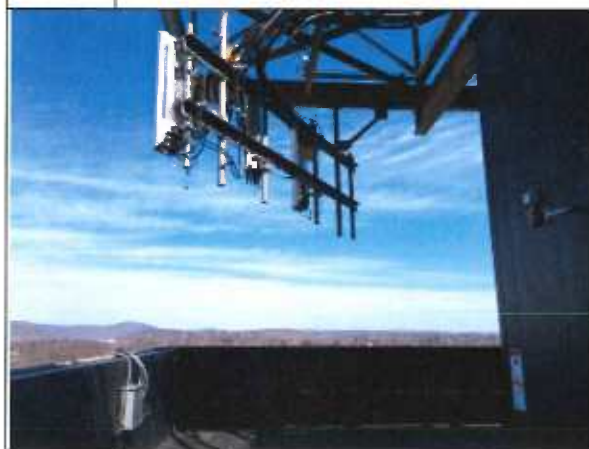
12. T-Mobile Sector C antennas
