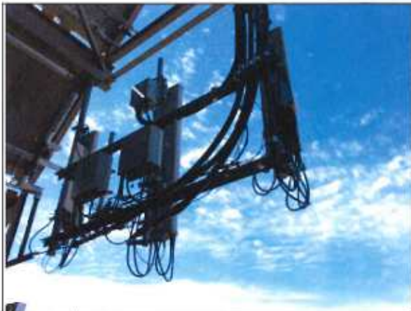
19. AT&T Sector C antennas
