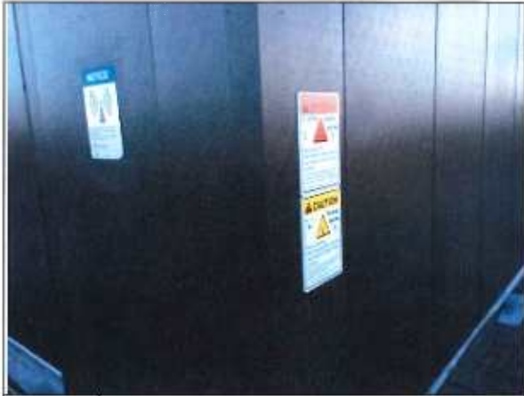
13. T-Mobile Sector C signage
