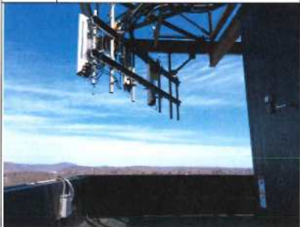
12. T-Mobile Sector C antennas
