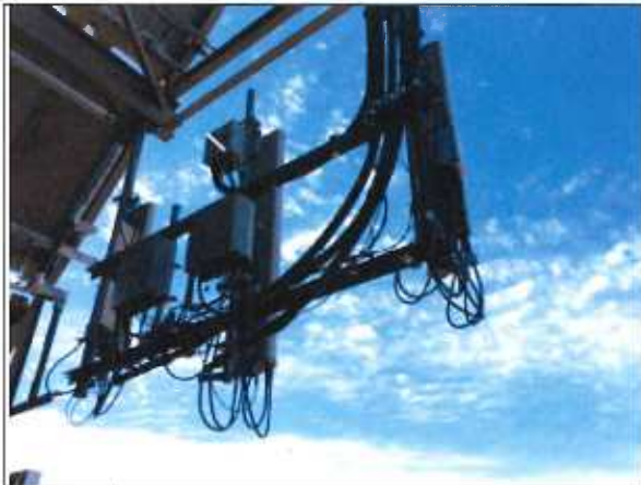
19. AT&T Sector C antennas
