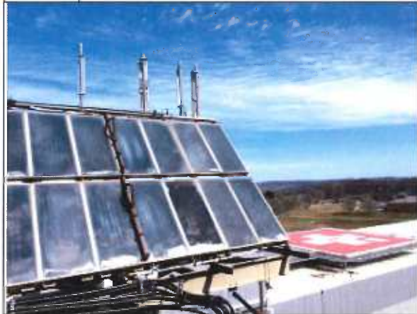
26. Verizon Sector A antennas
