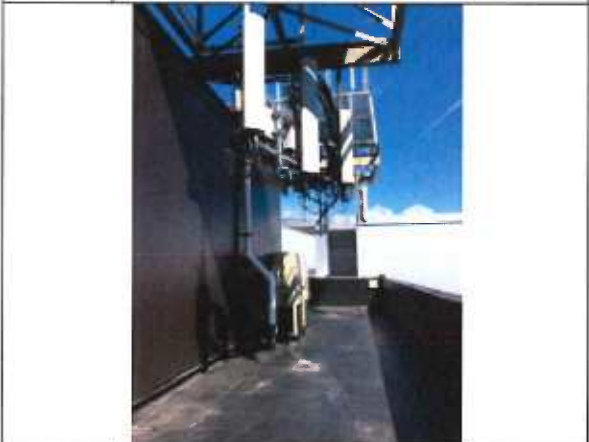
5. AT&T Sector B antennas
