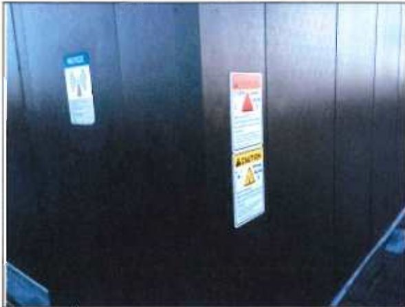
13. T-Mobile Sector C signage
