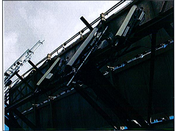
17. AT&T Sector A antennas
