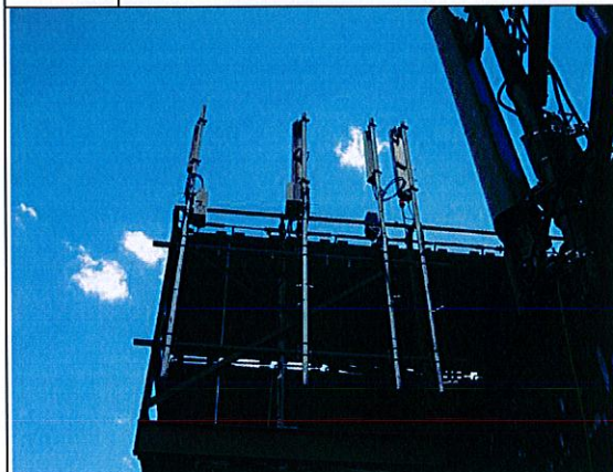
21. Verizon Sector B antennas
