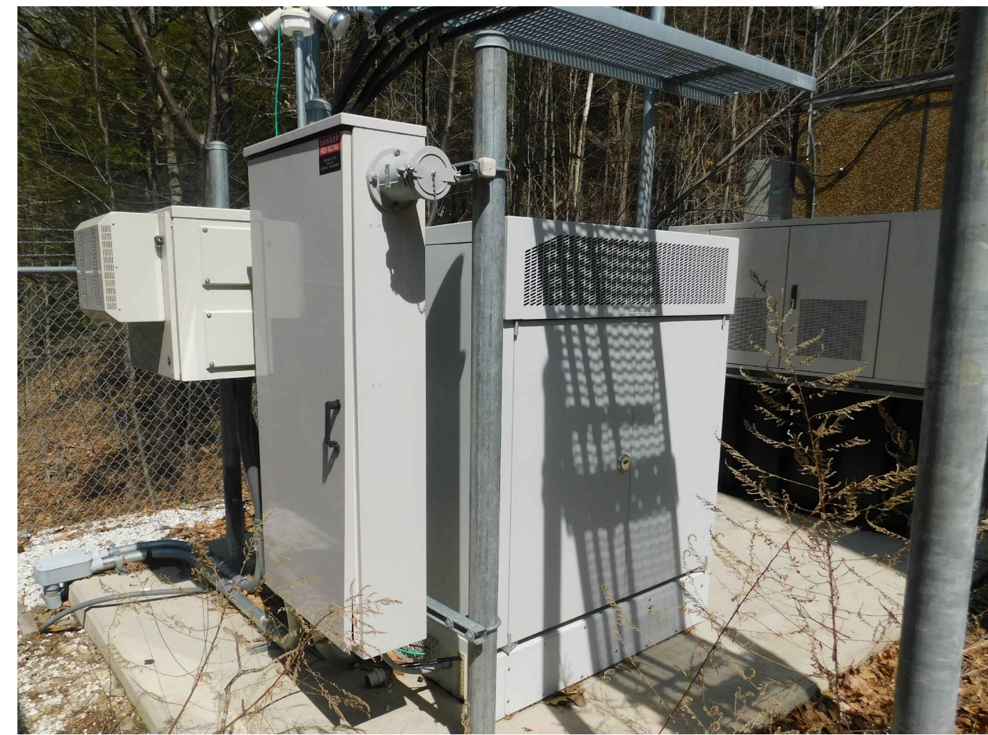
EXISTING EQUIPMENT PHOTO SCALE: N.T.S.
