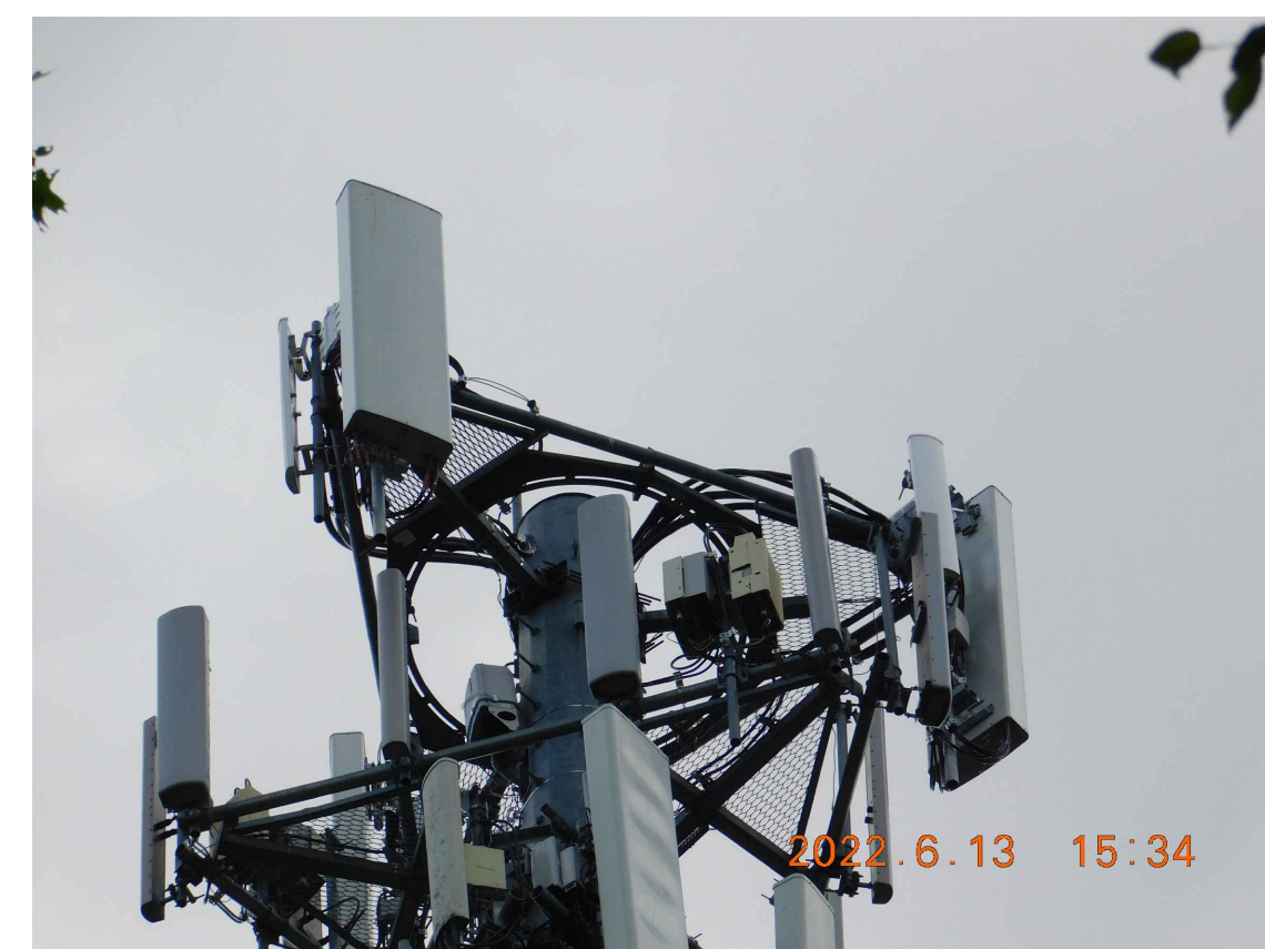
EXISTING ANTENNA PHOTO SCALE: N.T.S.
