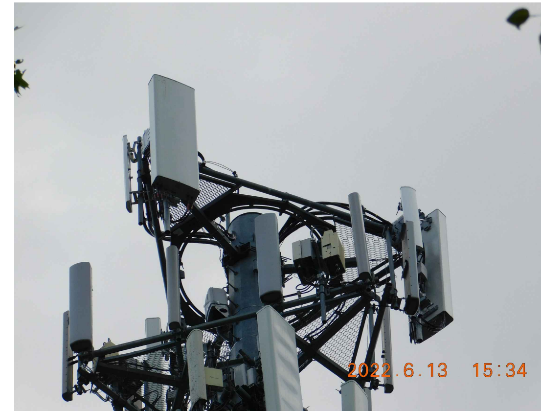
EXISTING ANTENNA PHOTO 3 SCALE: N.T.S. A-2
