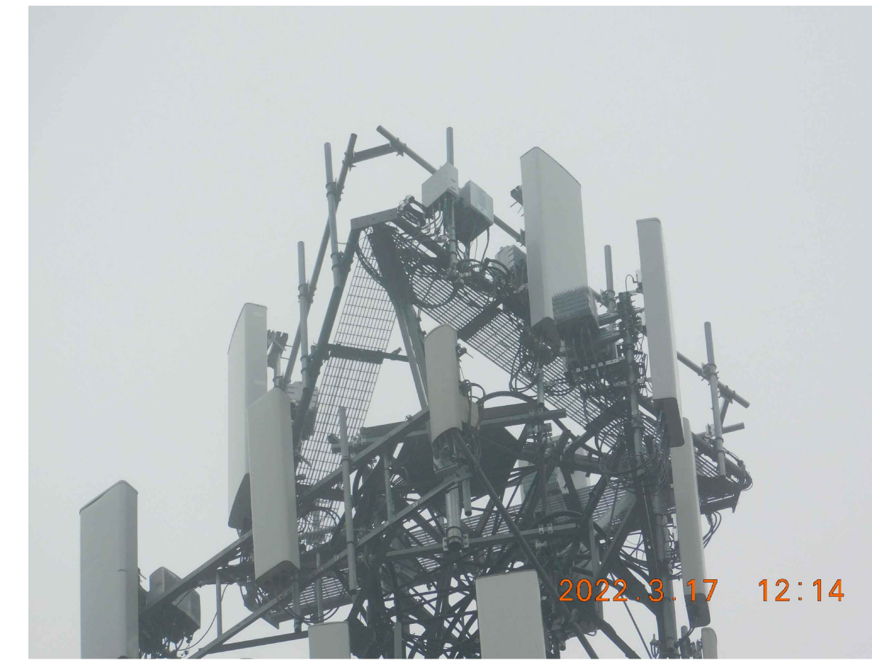
EXISTING ANTENNA PHOTO SCALE: N.T.S.
