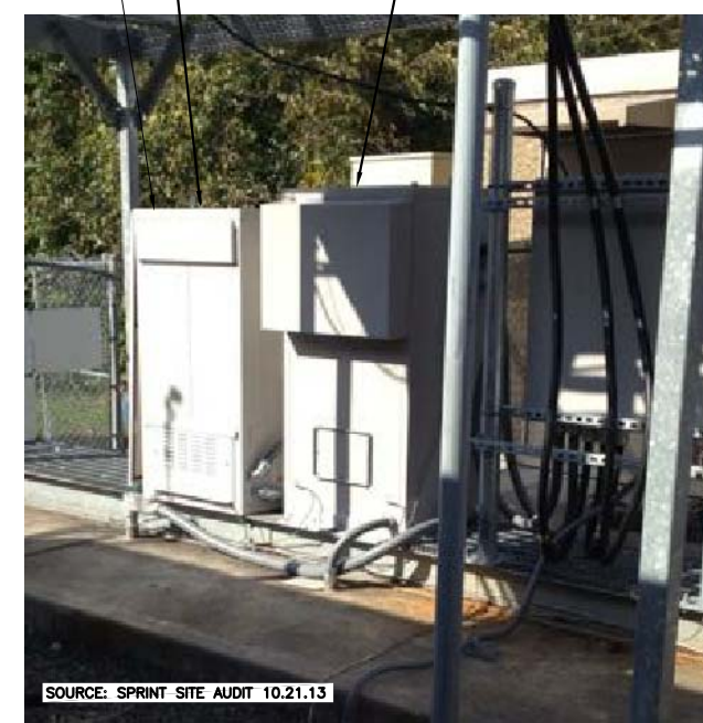
RAN EQUIPMENT PHOTO DETAIL 2 A-1 SCALE: N.T.S.
