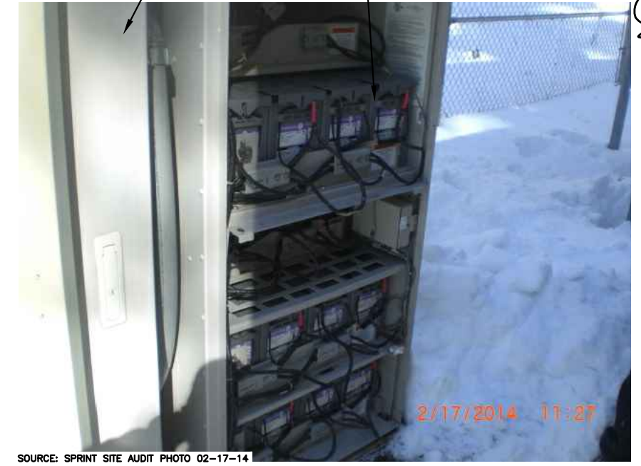
RAN EQUIPMENT PHOTO DETAIL 2 A-1 SCALE: N.T.S.
