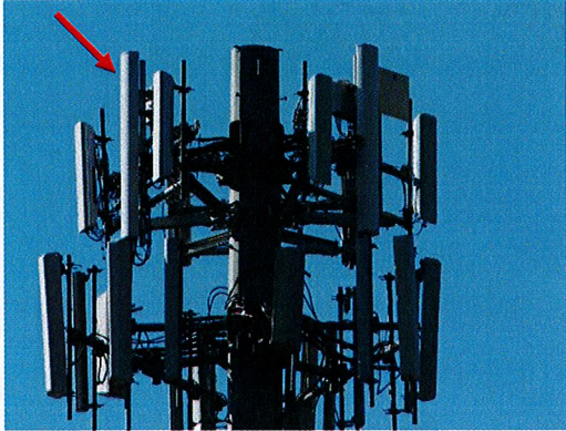
P-1: T-Mobile antennas
